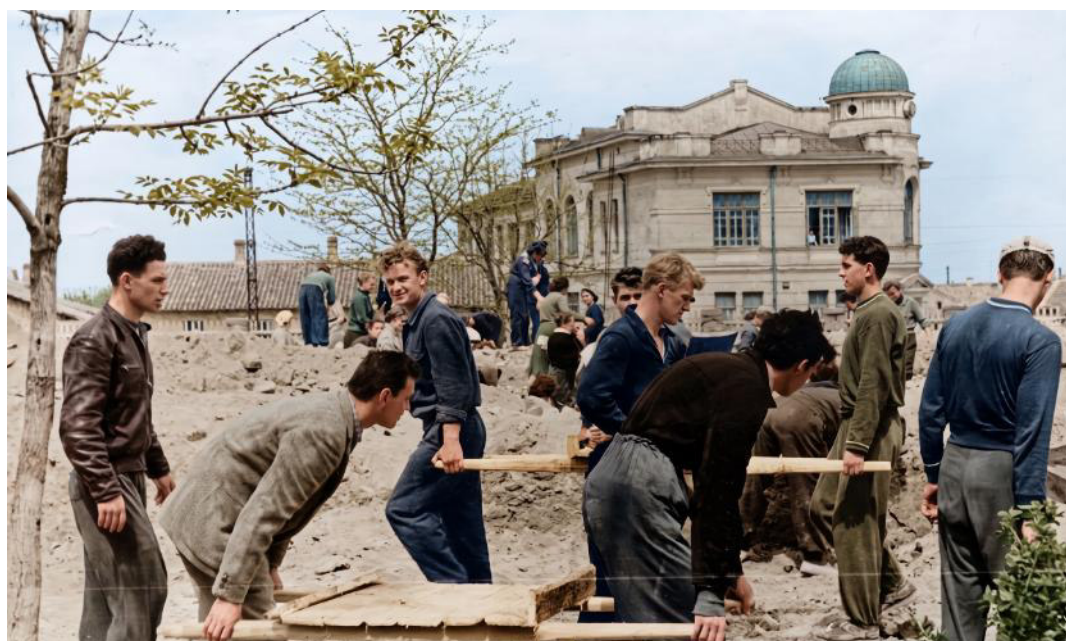
Рис. 32, 33. Студенты факультета физического воспитания во время строительства спортивных объектов на ул. Студенческой. 1950–1960-е гг.
